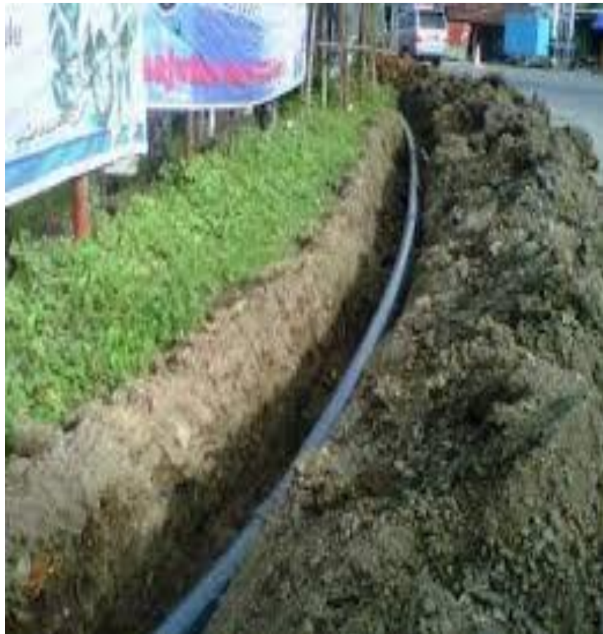
Gambar 2.9 Pipa pelayanan (pipa tersier)
