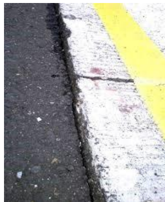
Gambar 2.6 Retak sambungan pelebaran jalan ( widening crack )
