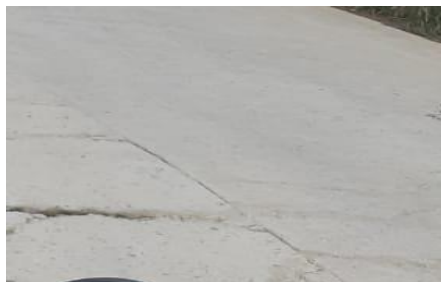
Gambar 2.5 Retak sambungan jalan ( lane joint crack )
