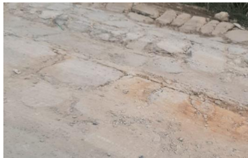
Gambar 2.3 Retak pinggir ( edge crack )
