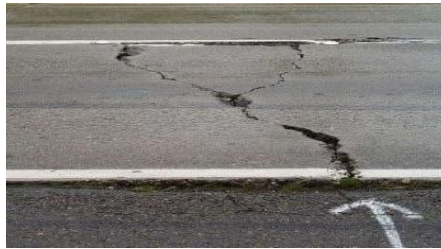
Gambar 2.4 Retak sambungan bahu perkerasan ( edge joint crack )
