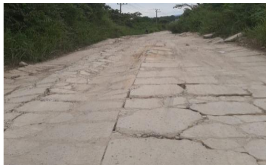
Gambar 2.2 Retak kulit buaya ( alligator crack )
