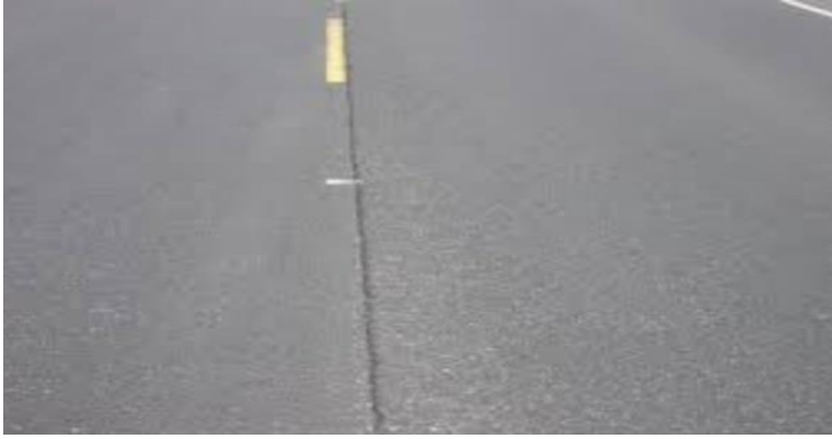
Gambar 2.7 Retak sambungan jalan
