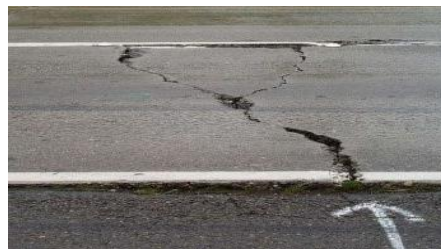
Gambar 2.4 Retak sambungan bahu perkerasan ( edge joint crack )
