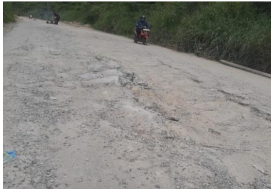
Gambar 2.7 Retak selip ( slippage crack )
