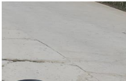
Gambar 2.5 Retak sambungan jalan ( lane joint crack )
