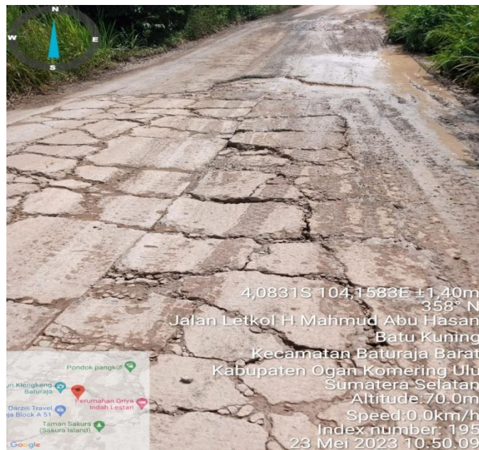
Gambar 2.2 Retak kulit buaya ( alligator crack )
