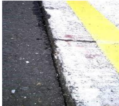
Gambar 2.6 Retak sambungan pelebaran jalan ( widening crack )
