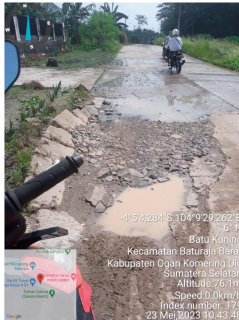
Gambar 2.3 Retak pinggir ( edge crack )
