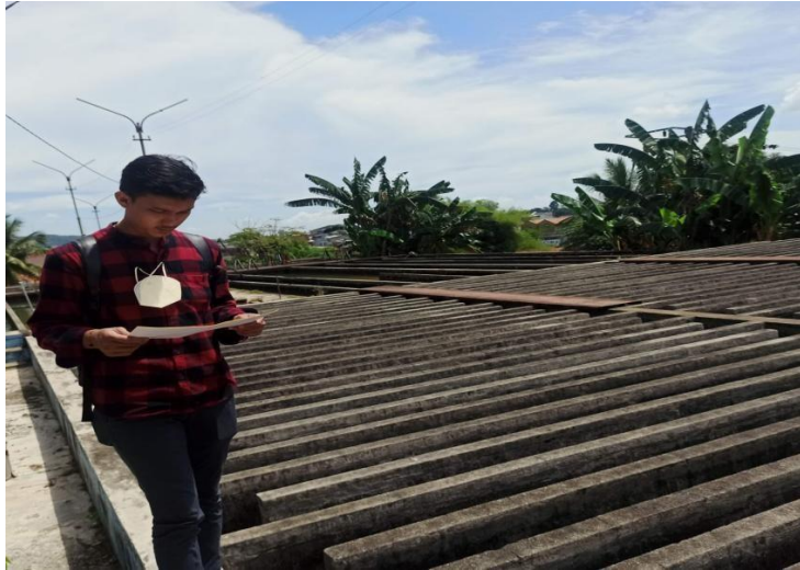
Lokasi Unit Pengolahan Filtrasi ( IPA )
