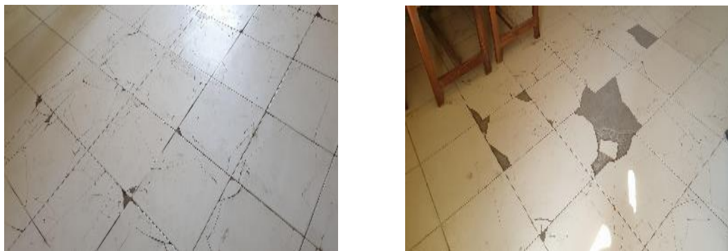
Gambar 2.4.2 Gambar Penutup lantai yang mengalami goresan dan retak
