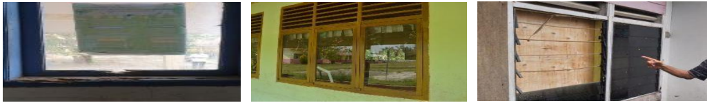
Gambar 2.4.3 Daun Jendela keropos, terjadi keretakan pada kaca dan kaca pecah
