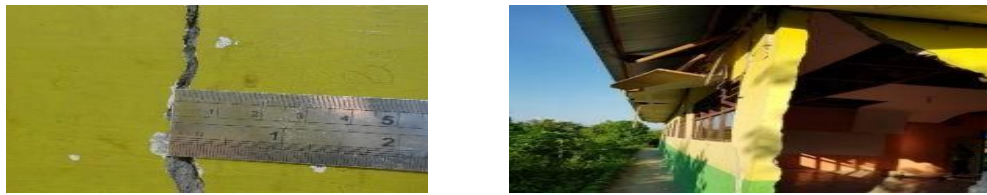
Gambar 2.4.1 Gambar keretakan pada dinding bangunan
