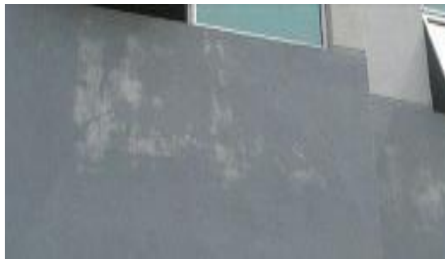
Gambar 2.4.4 Sebagian Mengalami Memudarnya Warna Cat Pada Tembok Bangunan
