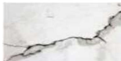
Retakan permukaan dinding lebar retakan kira-kira 0.2mm - 1.0mm)
