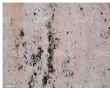
Cat dinding terkelupas dan berlumut
