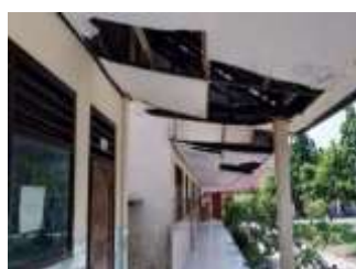
Penutup langit-langit melendut kemungkinan keruntuhan
