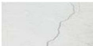
Retak rambut dipermukaan dinding (lebar retakan < 0.2 mm)
