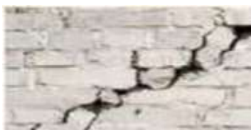
Dinding retakan meluas (lebar retakan kira-kira 1-2 mm)
