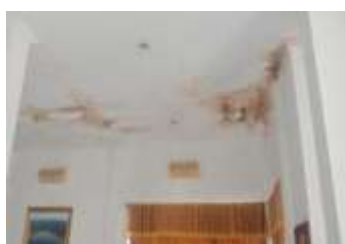
Indikasi kelembaban atau kemungkinan keruntuhan
