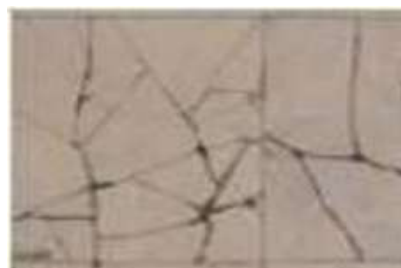
Penutup lantai retak sebagian
