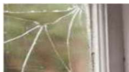
Penutup kaca retak
