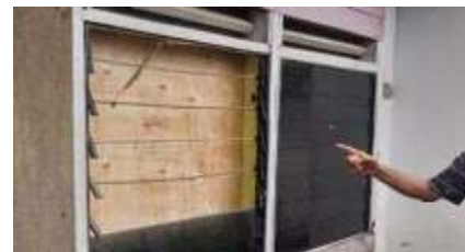
Penutup Kaca Retak Lebar/Pecah
