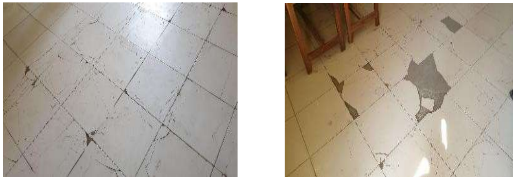
Gambar 2.3.2 Gambar Penutup lantai yang mengalami goresan dan retak
