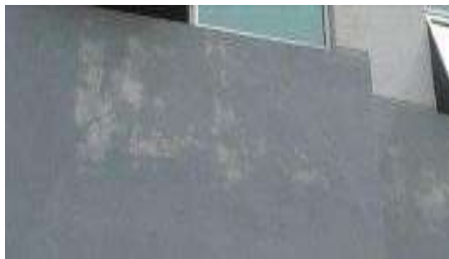
Gambar 2.3.4 Sebagian Mengalami Memudarnya Warna Cat Pada Tembok Bangunan
