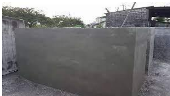
Gambar : 2.11 Reservoir dari beton
