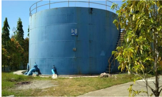
Gambar : 2.10 Reservoir dari baja
