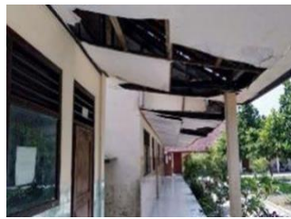
Penutup langit-langit melendut kemungkinan keruntuhan
