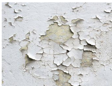
Cat dinding terkelupas
