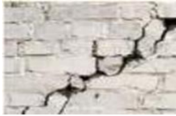
Dinding retakan meluas (lebar retakan kira-kira 1-2 mm)
