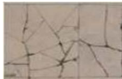
Penutup lantai retak sebagian
