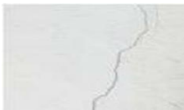
Retak rambut dipermukaan dinding (lebar retakan < 0.2 mm)
