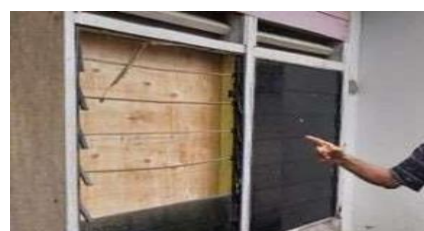
Penutup Kaca Retak Lebar/Pecah
